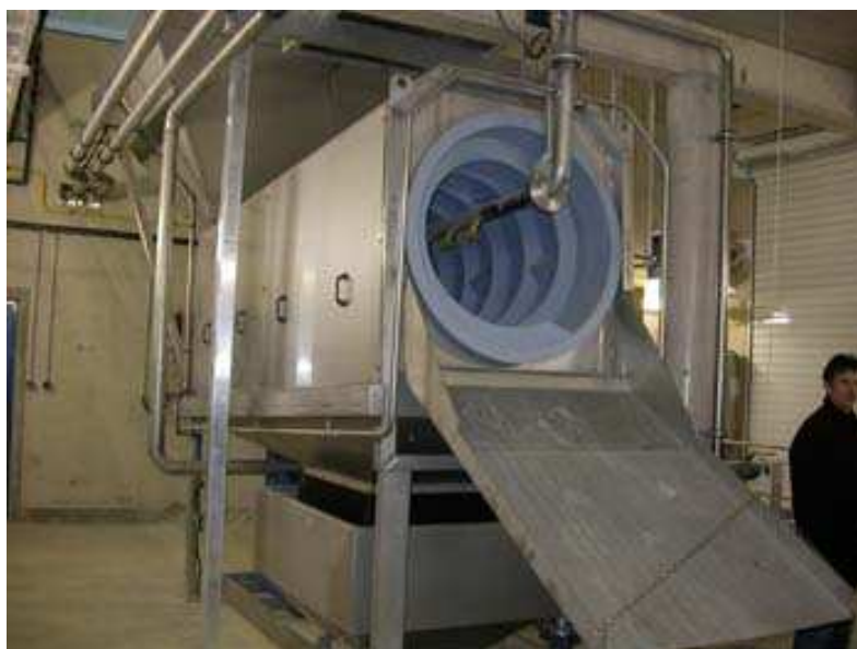
Nouvelle station d'épuration de la Communauté de Communes de l'Agglomération de Vesoul
